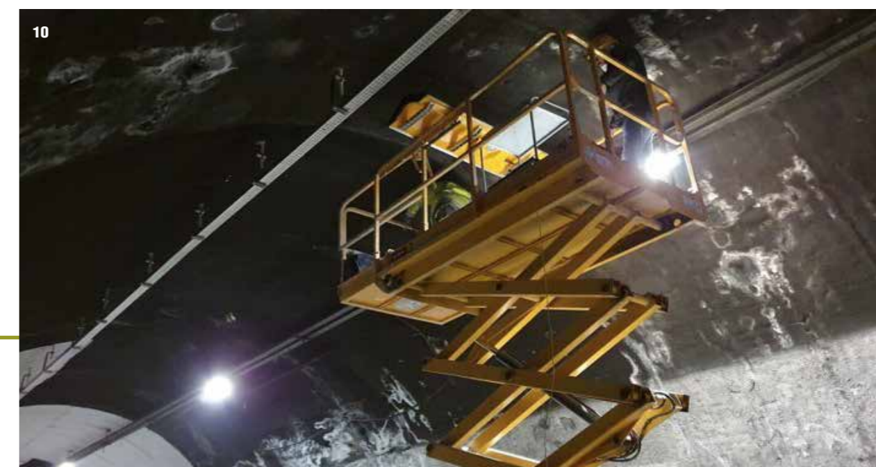
10. Indagini in galleria effettuati dagli specialisti di MTS Engineering con strumentazione 3D-Radar
